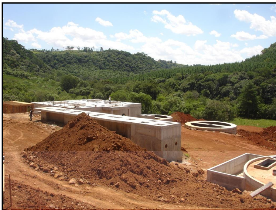
Figura 5: Estação de Tratamento de Esgoto do Município de Abelardo Luz Fase de Implantação.
