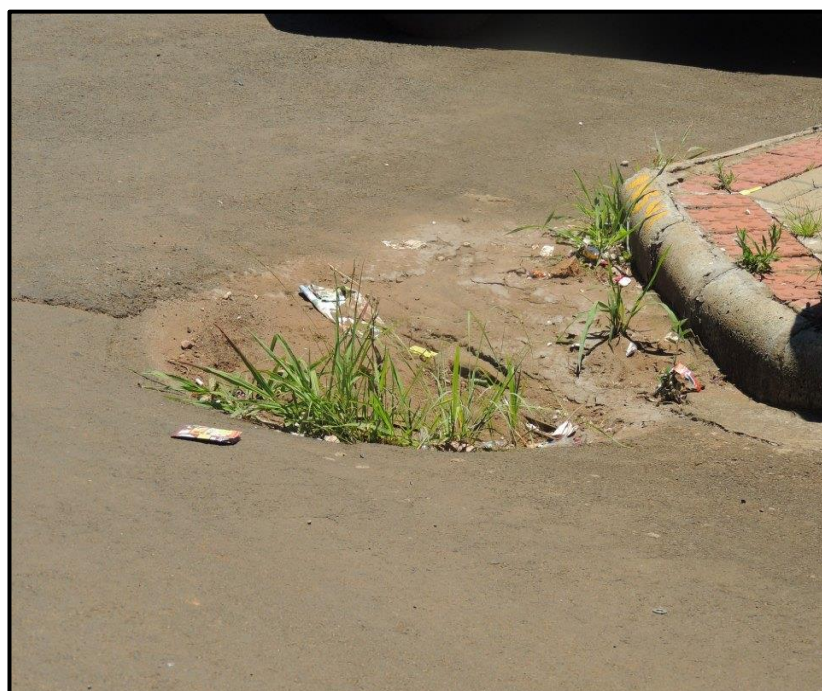
Figura 39: Acúmulo de sedimentos – falha no sistema de drenagem urbana.
