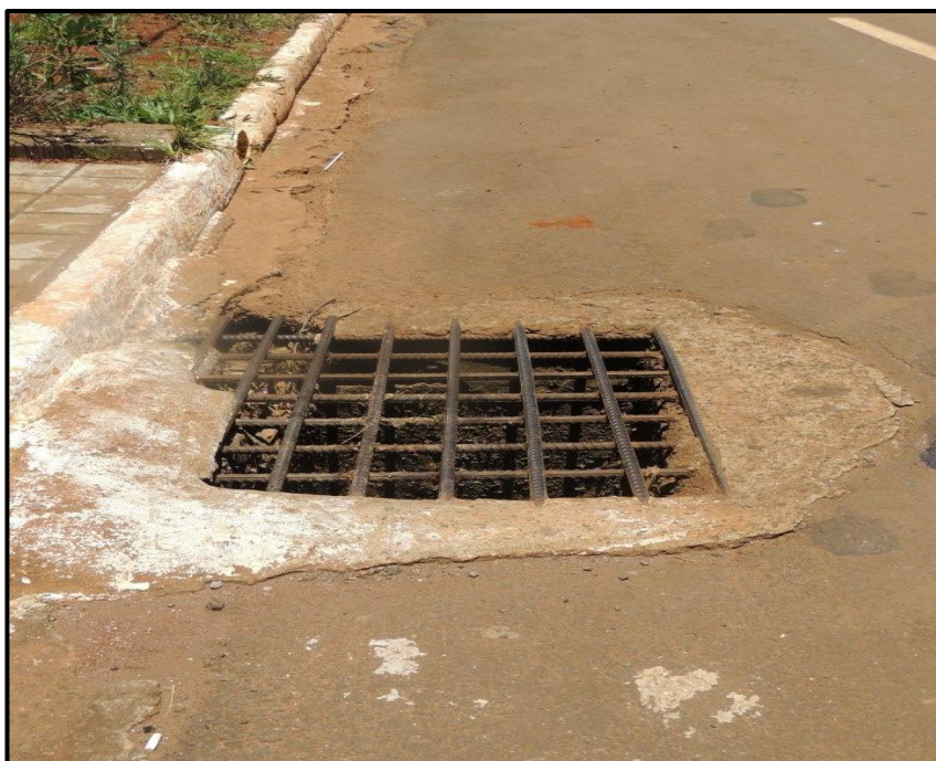
Figura 38: Boca de Lobo com Grelha.
