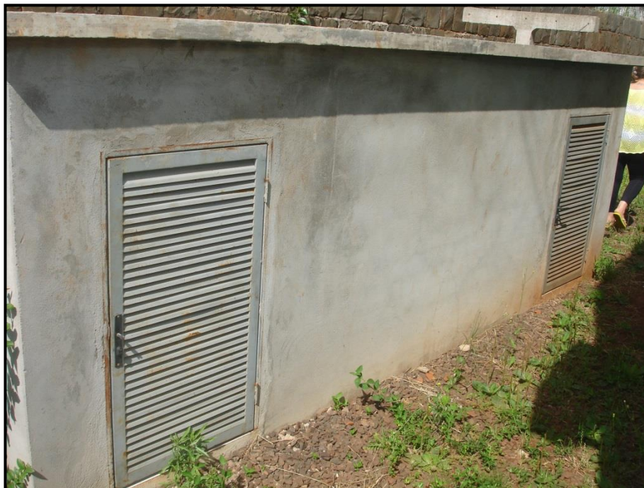
Figura 20: Local de acondicionamento de resíduos – UBS Bairro Aparecida
