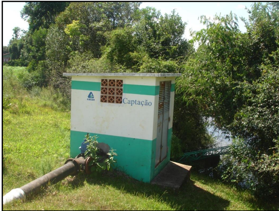
Figura 1: Captação de água do Rio Chapecó - CASAN.
